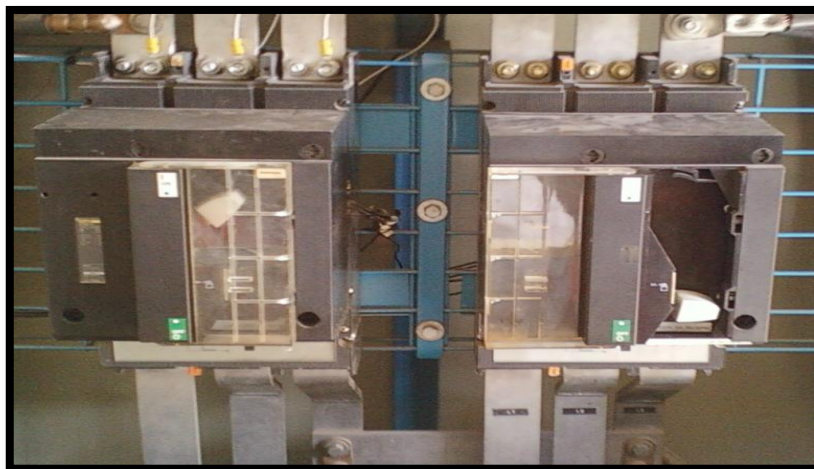
Figura 3.13: Contactores Merlin Gerin.
