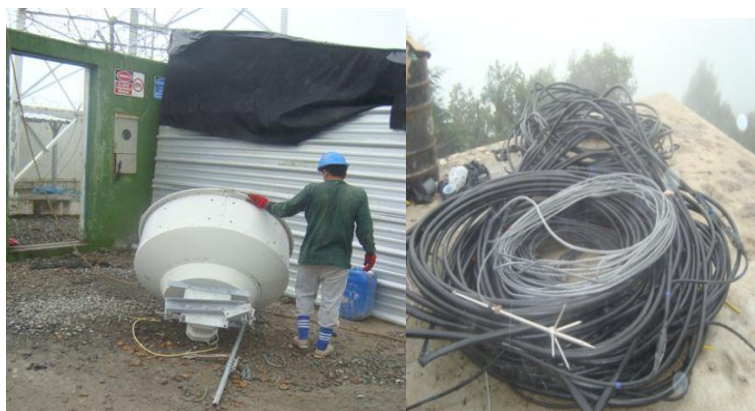
Figura 2.12 Antena Microonda y cableado para torre de 24 metros de altura 20
