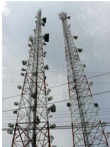
Figura 2.13 Torres de 60 metros de altura con antenas Microondas (Monjas-Quito) 21
