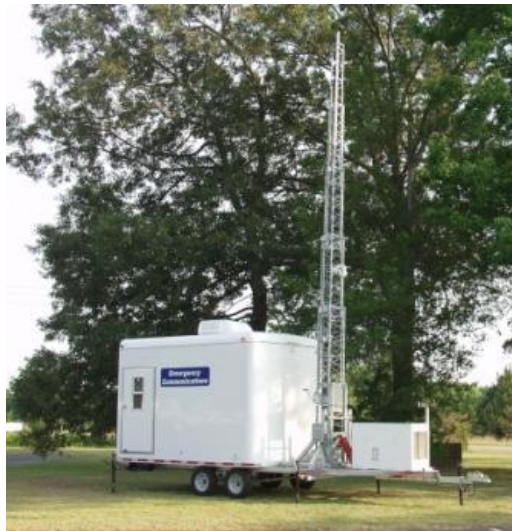
Figura 2.6 Torre móvil o estación de rápido despliegue ERD 13
