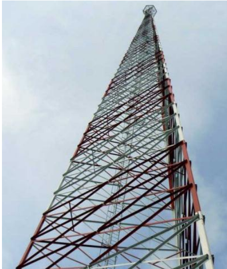
Figura 2.1 Torre autoportada de telecomunicaciones de 102 metros de altura 7
