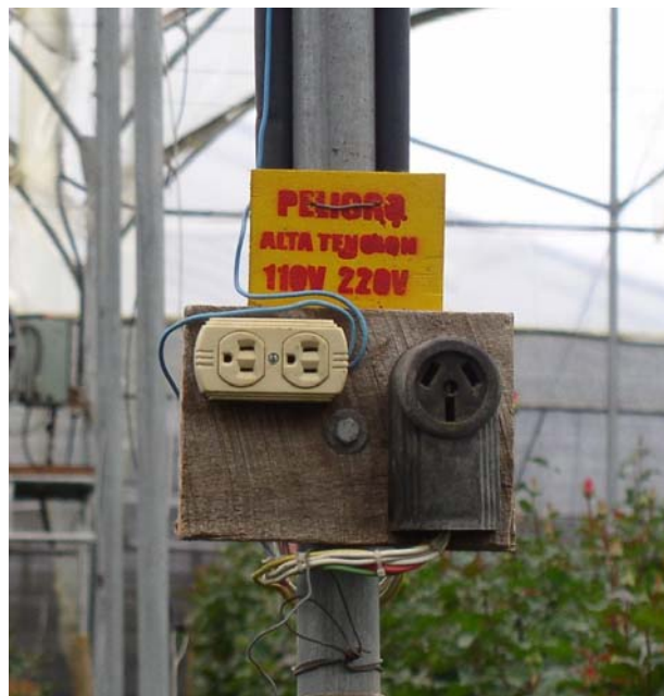
Figura 2.7 Tomas eléctricas dentro de los invernaderos
