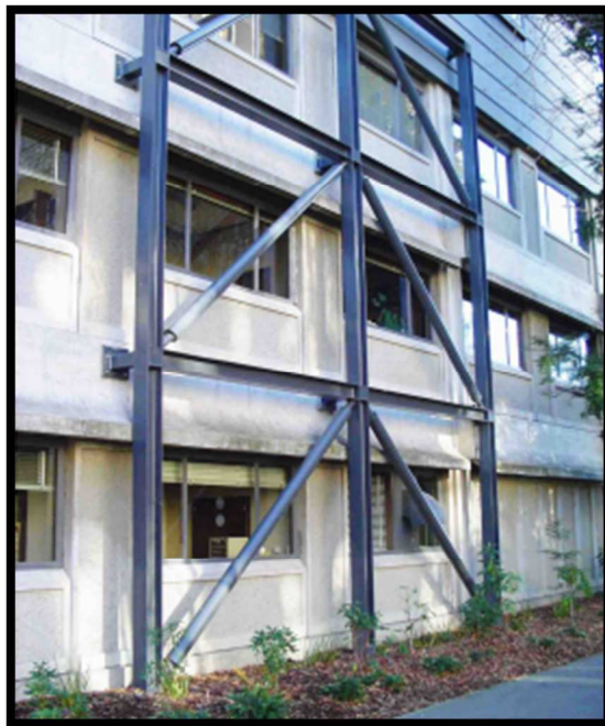
Figura 2.4. Vista de un pórtico arriostrado concéntrico utilizado para la rehabilitación de una estructura existente de hormigón armado.
