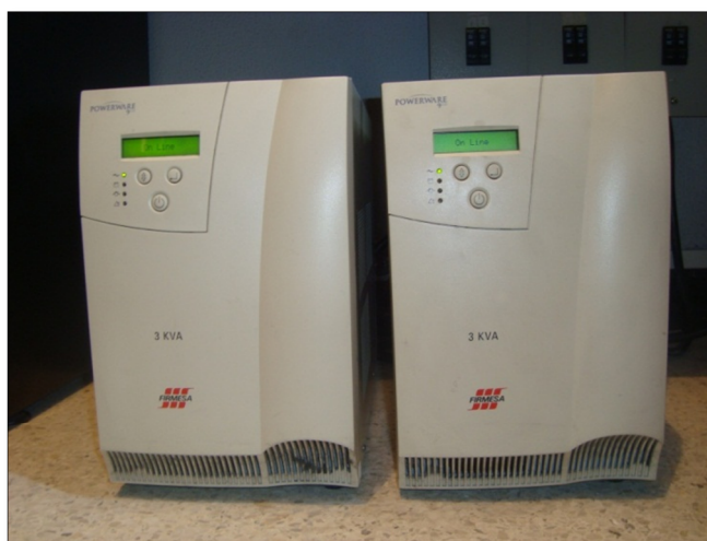
Figura 5.23. Reguladores UPS Powerware 9120 .
