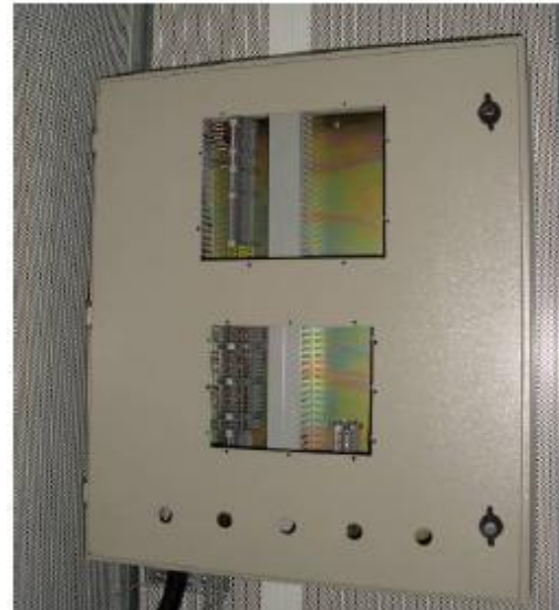
Figura. 2 Tablero de Control
