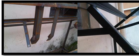
Figura 5.15. Soldadura de los soporte de la columna de dirección Fuente: Los Autores
