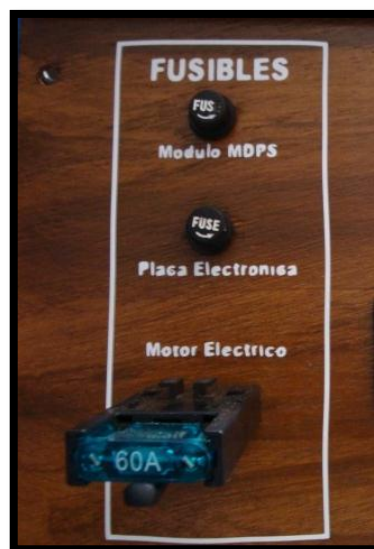
Fusibles Fuente: Los Autores
