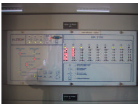
Figura 2- 6. Unidad Controladora de Bahía (S/E Pomasqui, Santa Rosa 230 kV)
