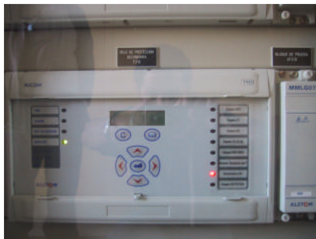
Figura 2- 7. IED de protección (Subestación Pomasqui)
