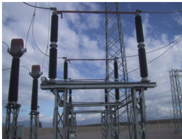
Figura 1- 5. Seccionadores ó aisladores.
