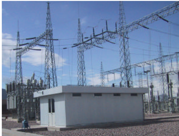
Figura 7- 4. Cuarto de Control de Bahías, junto al proceso (S/E Pomasqui)
