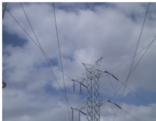
Figura 1- 2. Torre de Alta Tensión y Líneas de Transporte
