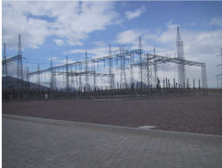
Figura 1- 3. Patio de Maniobras de una Subestación (Subestación de Transmisión Pomasqui TRANSELECTRIC S.A.)
