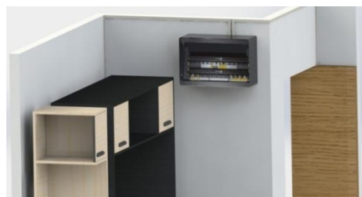
Fig. 5. Ubicación del rack, switch y patch panel
