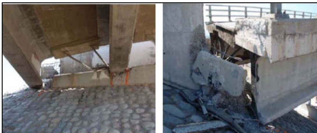
Fig. 4.18 Falla del tope transversa del Puente Las Mercedes.
