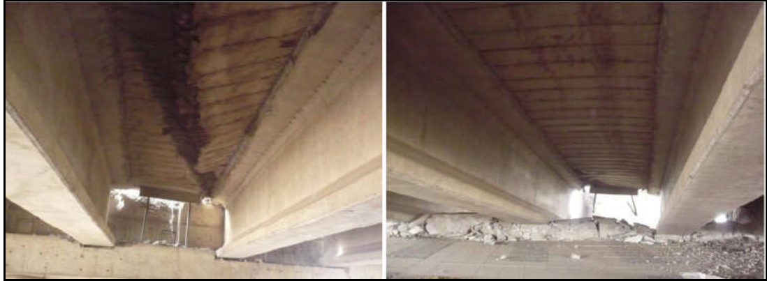
Fig. 4.13 Puente Llacolen, daño en tablero y apoyo
