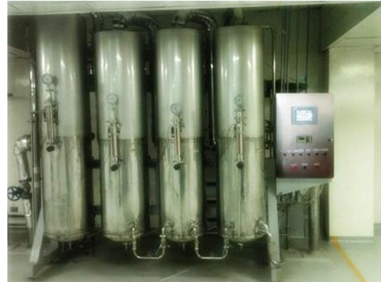
Fig. 22 Nuevo sistema de monitoreo, supervisión y control del proceso de destilación de agua
