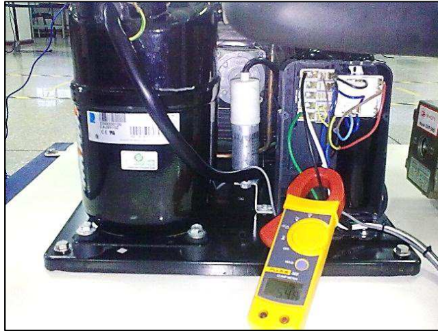
Figura 2.13 Medición del consumo de corriente del compresor
