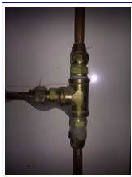
Figura 4.30 Conexión con fugas
