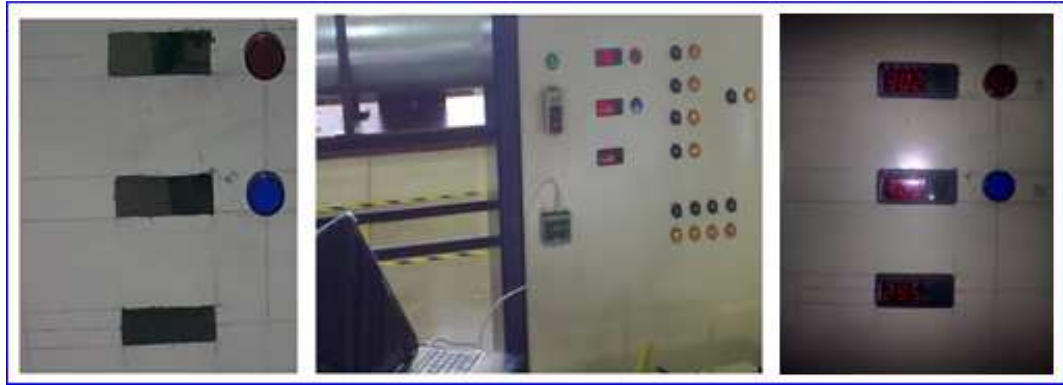
Figura 4.24 Montaje final de presostatos y termómetro
