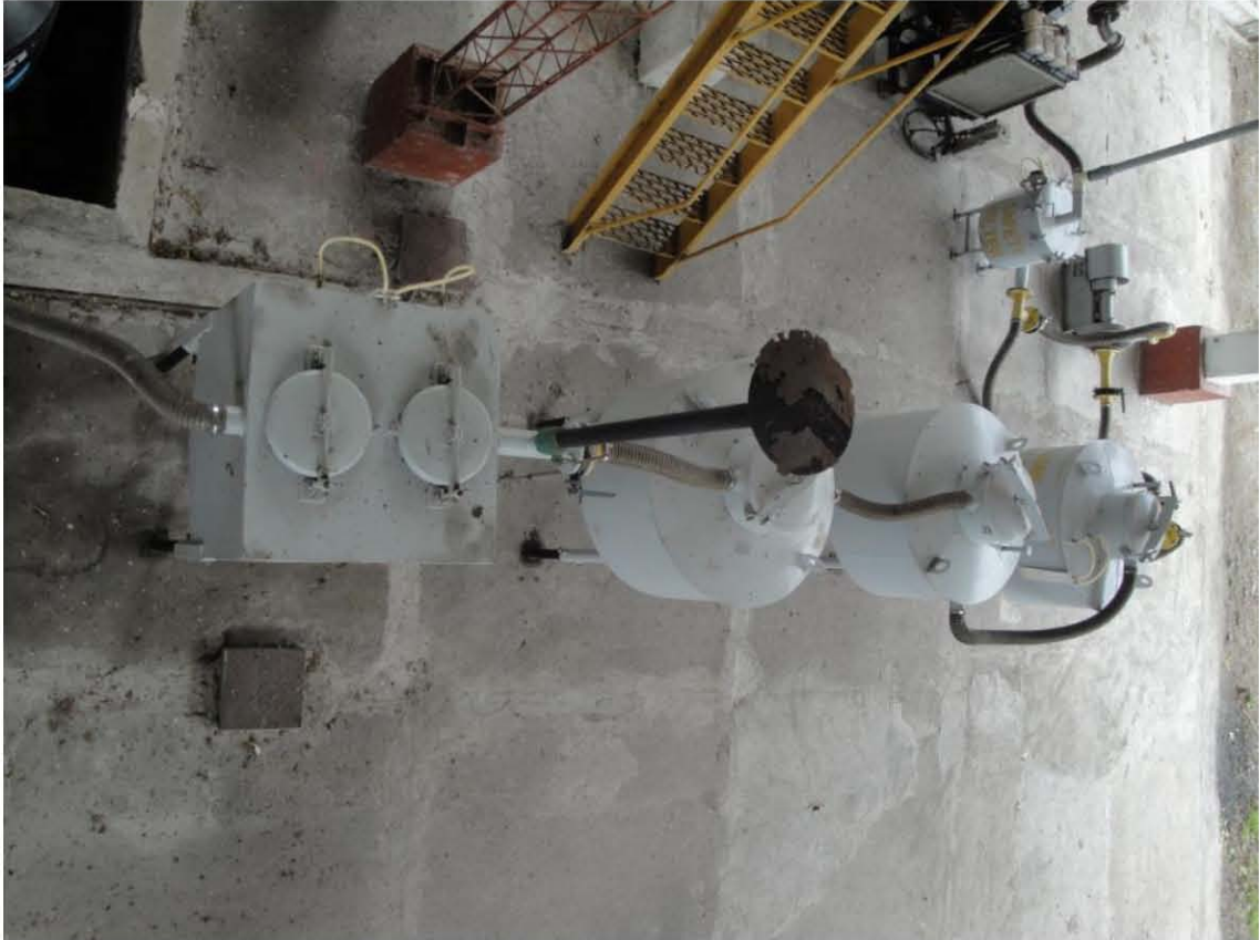
Figura 4.2 Planta generadora de la Concordia
