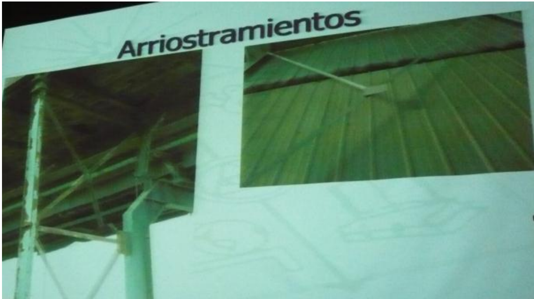
Figura 1.3 Comportamiento Sísmico de Arriostramientos durante el Mega Sismo de Chile de 2010.
