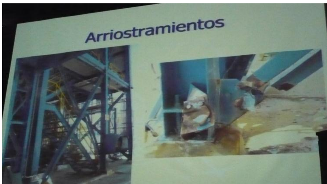
Figura 1.4 Falla en los apoyos de diagonales de acero durante el sismo de Chile de 2010.
