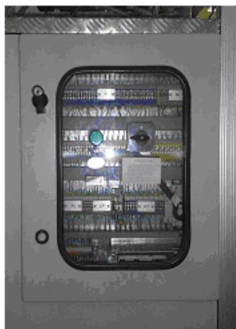
Figura. 2.10. Tablero de Control de la Estación Neumática PN-2800.
