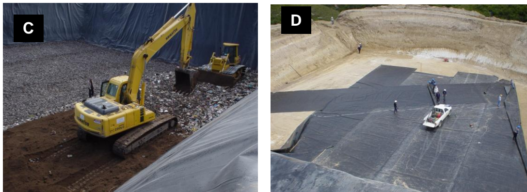
Figura 2.11 Parámetros de construcción R. S. “El Inga”: c) Aislamiento de RSU con Material de cobertura y d) Colocación de geomembrana
