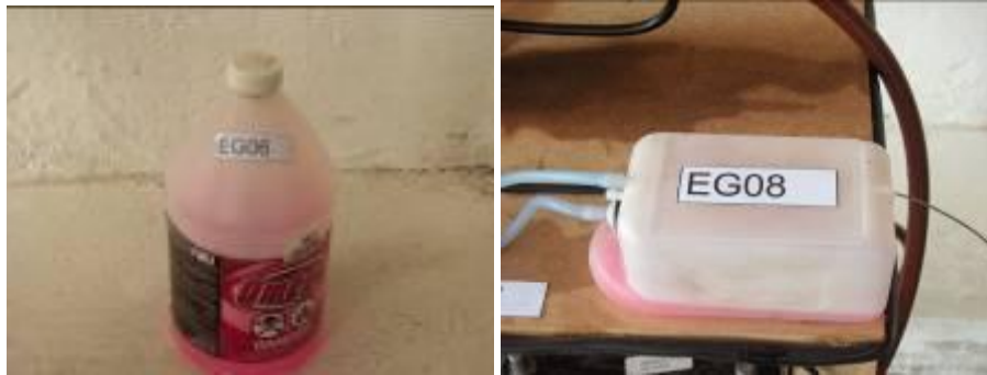
Figura 5.18 Combustible al 15% y Tanque de combustible con mangueras de neopreno.
