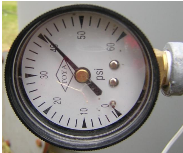
Figura 5.13 Presión de 40 psi (tanque de acumulación)
