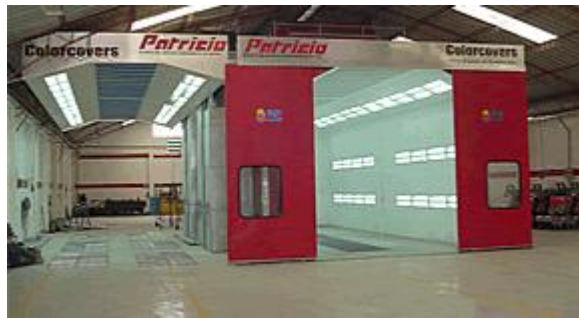
Fig. 6.12 Cabina de pintura
