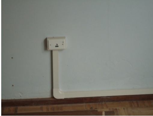
Figura 3. 17: Canaleta instalada en el CIMAM
