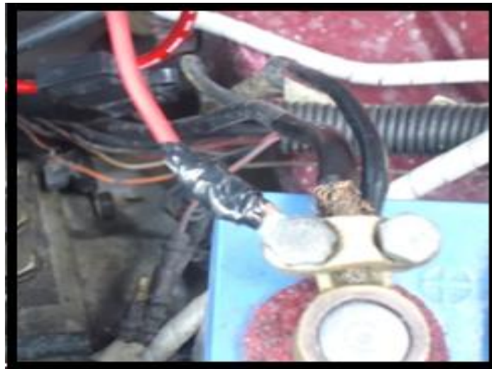
Figura N° 61: Conexión de los cables para los bornes
