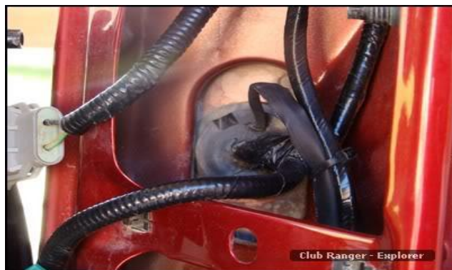
Figura N° 22: Así queda el cableado cuando ya está colocado
