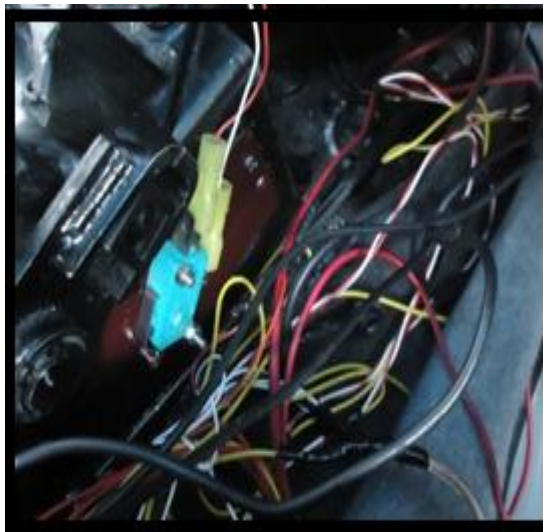
Figura N° 55: El Cableado que viene a los módulos
