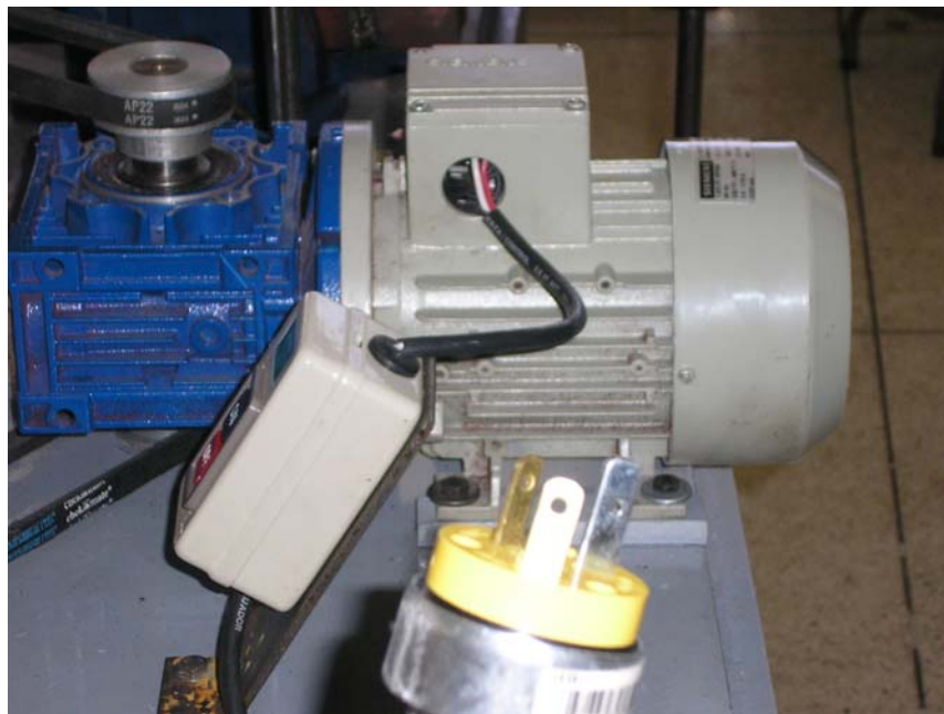
FIG. 4.67 SISTEMA ELÉCTRICO DE LA MAQUINA PULIDORA
