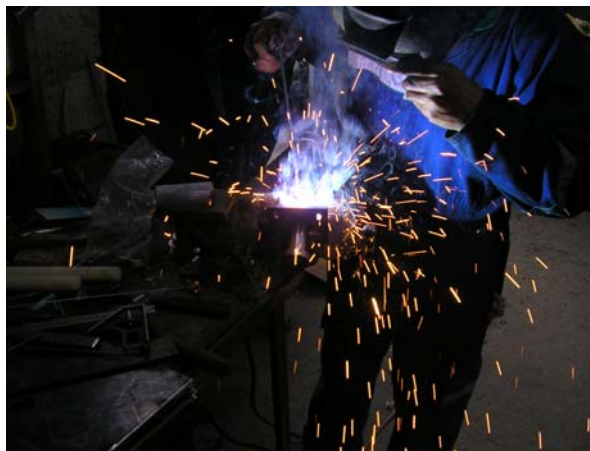
FIG. 4.30 SUELDA DE PLACA CON OJO CHINO A LA CAMISA DE LA CHUMACERA
