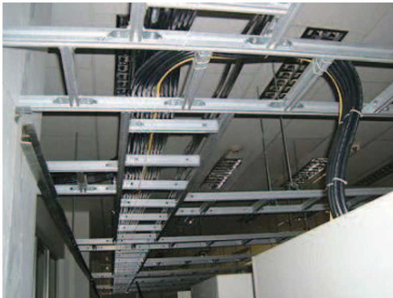
Figura 5.7: Instalación eléctrica visible.
