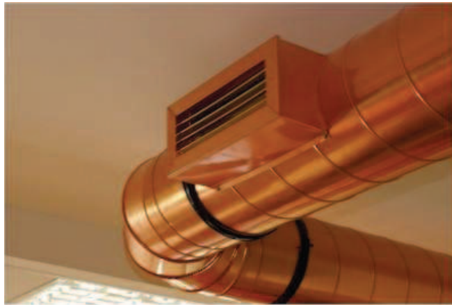
Figura 5.14: Compuertas en conductos de aire.
