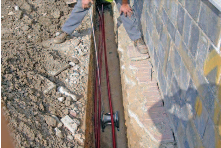
Figura 5.10: Instalación Eléctrica Subterránea.
