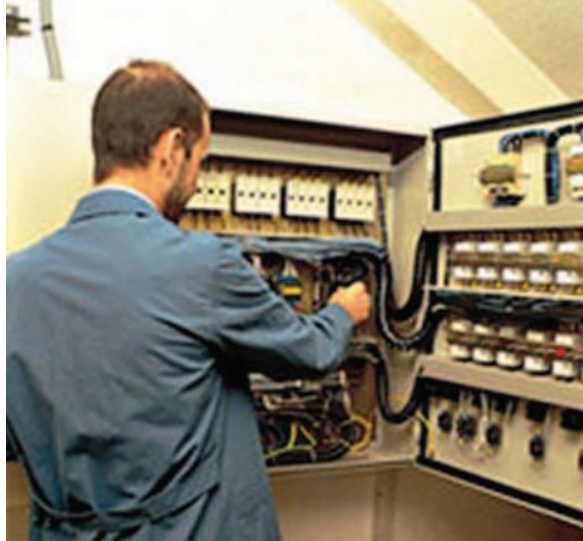
Figura 5.12: Instalación eléctrica, Lugar Seco.
