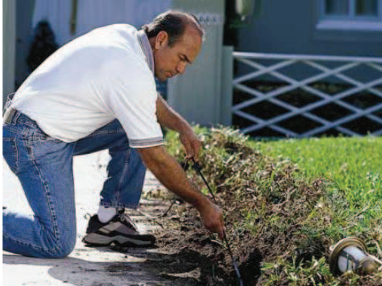
Figura 5.11: Instalación eléctrica exterior para iluminación.
