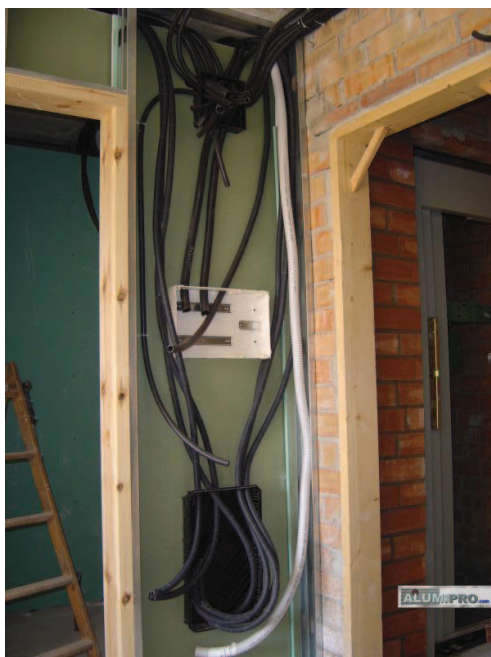
Figura 5.8: Instalación eléctrica oculta.
