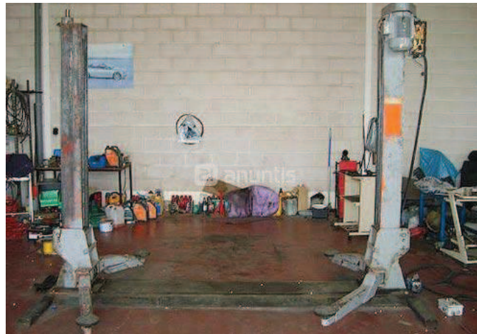
Figura 5.13: Instalación eléctrica, para una grúa de carga en un autoservicio.
