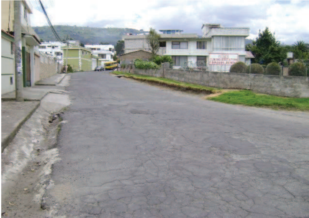
Figura 4.5: Estado de calles aledañas al Centro Educativo
