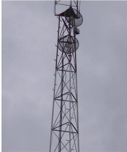
Figura. 3.9 Antenas de Microonda
