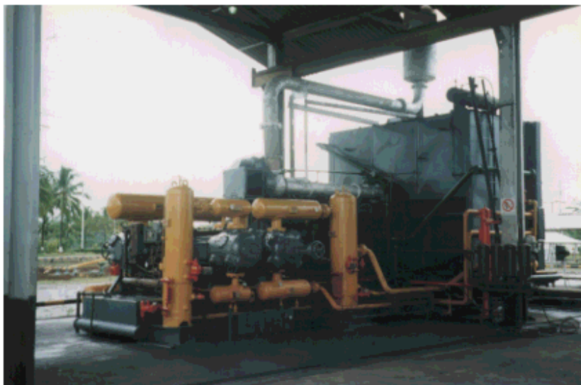
Figura. 2.15 Motocompresores de gas
