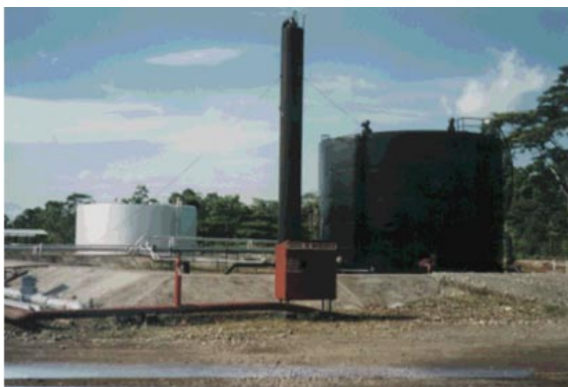
Figura. 2.8 Separador vertical y tanques
