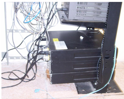
Figura. 3.12 Cableado y dispositivos de red
