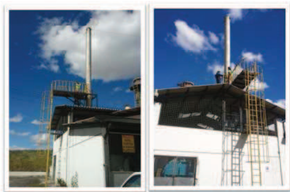
Figura 4. 7 Incinerador del Aeropuerto Mariscal Sucre
