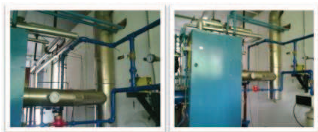
Figura 4. 3 Tuberías de escape
