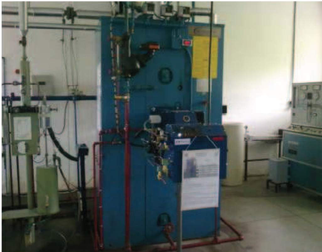
Figura 4. 1 Caldero del laboratorio de Termodinámica del Departamento de Ciencias de la Energía y Mecánica de la ESPE
