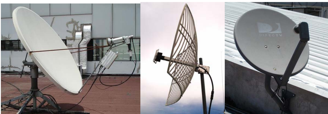
Figura 3.19. Antenas Reflectoras instaladas en el Aeropuerto
