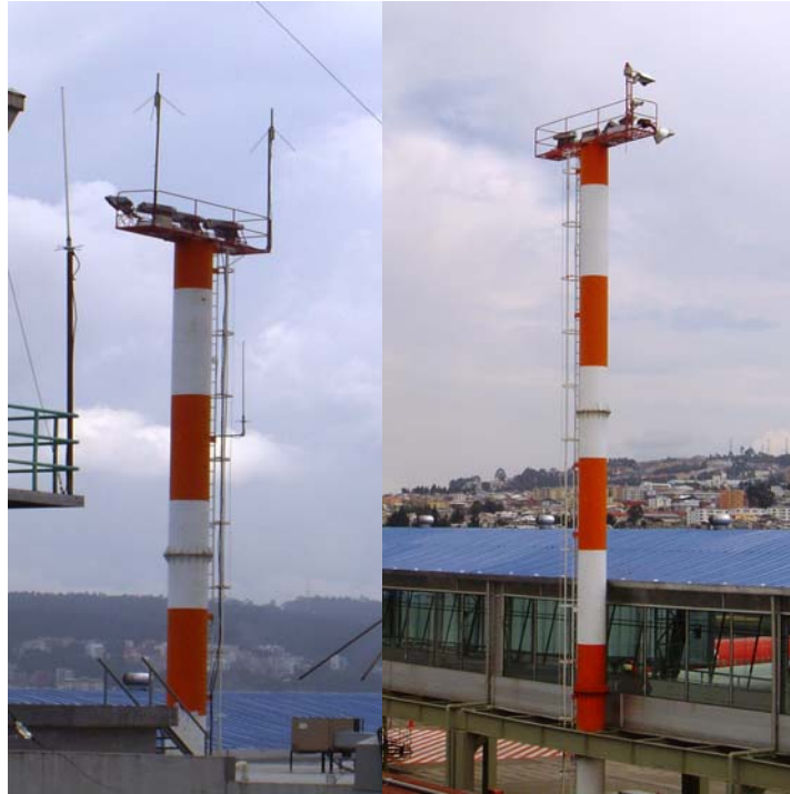
Figura 3.1. Estructuras de soporte tipo monopolo
