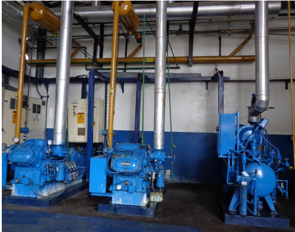
Figura 1.1: Compresores del sistema de enfriamiento
