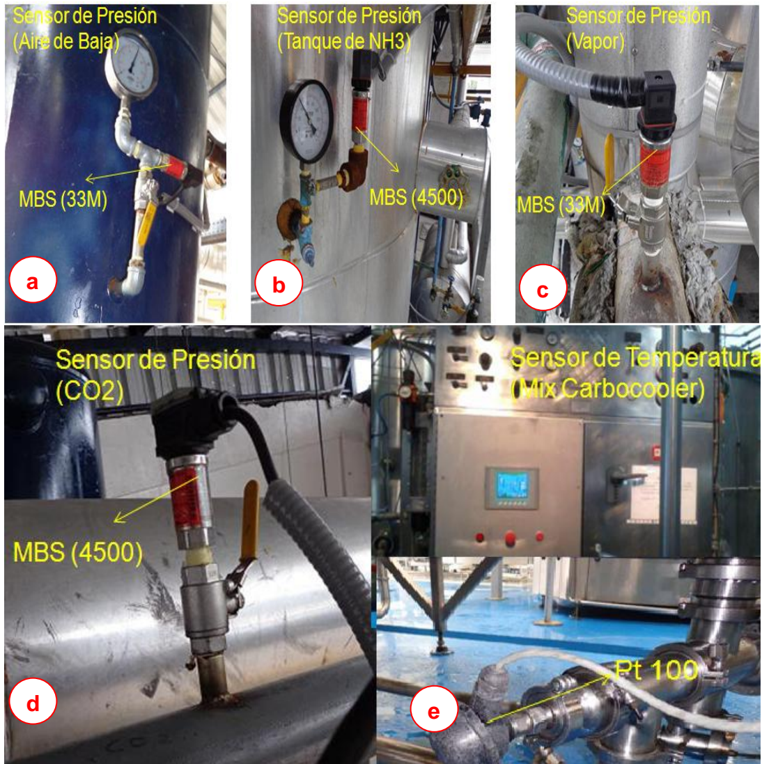
Figura 3.42: Montaje final de los transmisores de presión y temperatura, a) Sensor de presión (aire de baja), b) Sensor de presión (Tanque de NH3), c) Sensor de presión (Vapor), d) Sensor de presión (CO2), e) Sensor de Temperatura (Mix Carbocooler)
