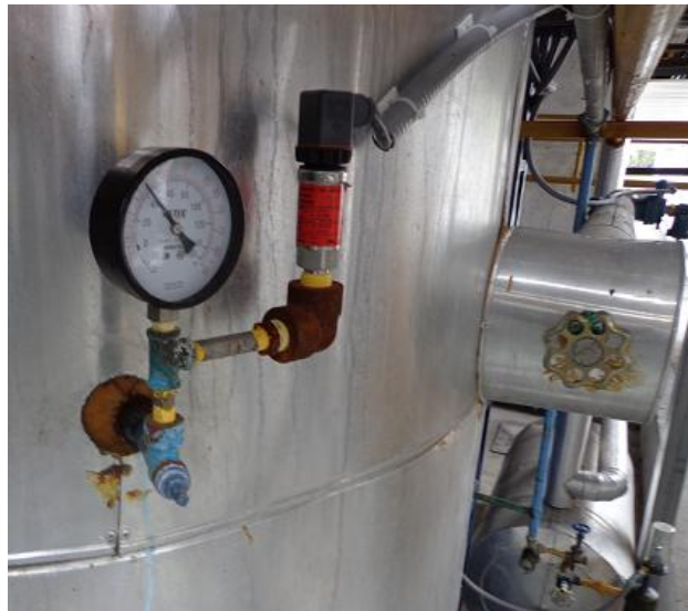
Sensor de presión Tanque de NH3 (MBS 4500)
