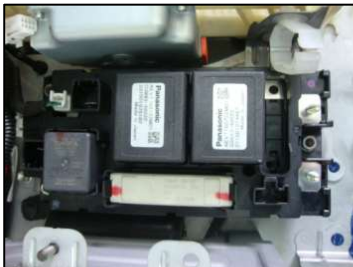
Fuente: Luis Espinosa. Figura 2.19 Vista de la ECU de la batería y de los relés de la batería.
