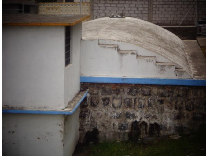
Foto N° 2.18: Tanque de Reserva La Alsacia (Pequeño) m 3 : 142,84
