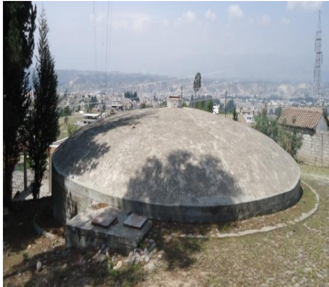
Foto N° 2.19: Tanque de reserva San Martín m 3 : 995,38
