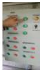
Figura.a.9 Control de niveles de agua en tablero de control
