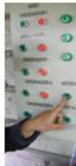
Figura. a.7 Operación de bomba de recirculación
