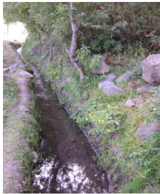
Figura. 1.10 Canal de entrada de agua a las piscinas para la Finca San Nicolás
