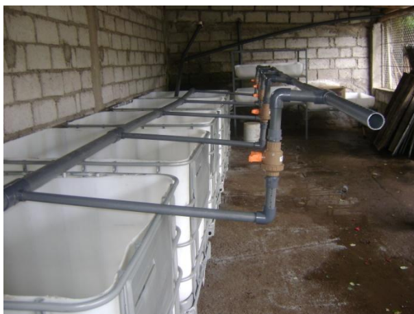
TUBERIA DE ENTRADA DE AGUA
