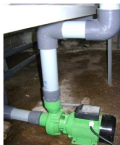
Figura 2.19 Implementación de bomba centrífuga
