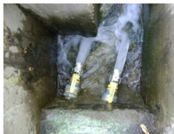
Figura 1.18 Canales de desagüe
