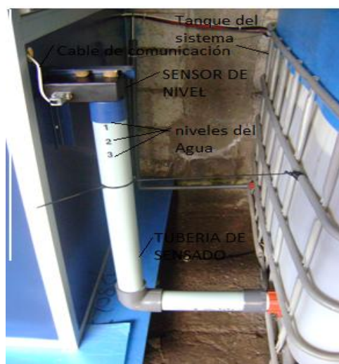
Figura.2.22. Implementación de sensor de nivel en el sistema
