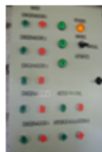
Figura. a.5 Tablero de control del sistema
