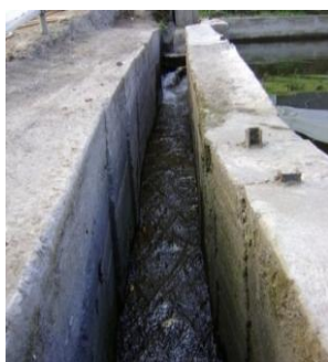
Figura.1.11 Canal de salida de agua de las piscinas
