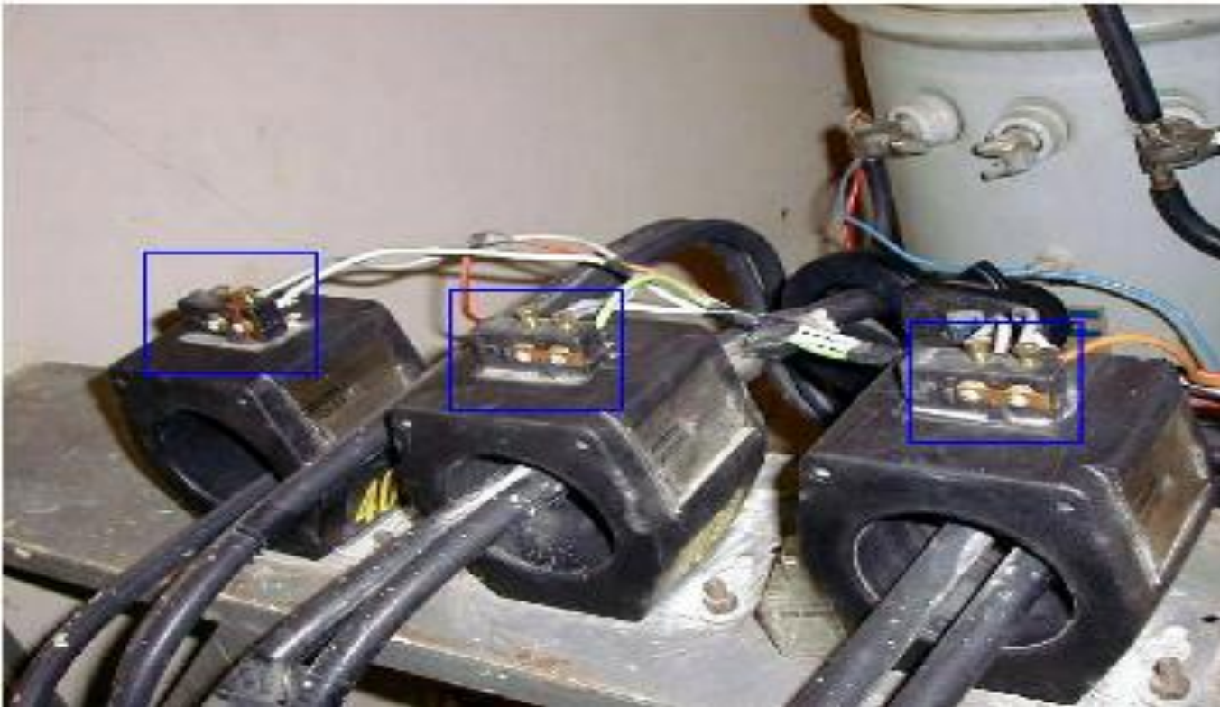
Intervenciones de las señales de corriente.
