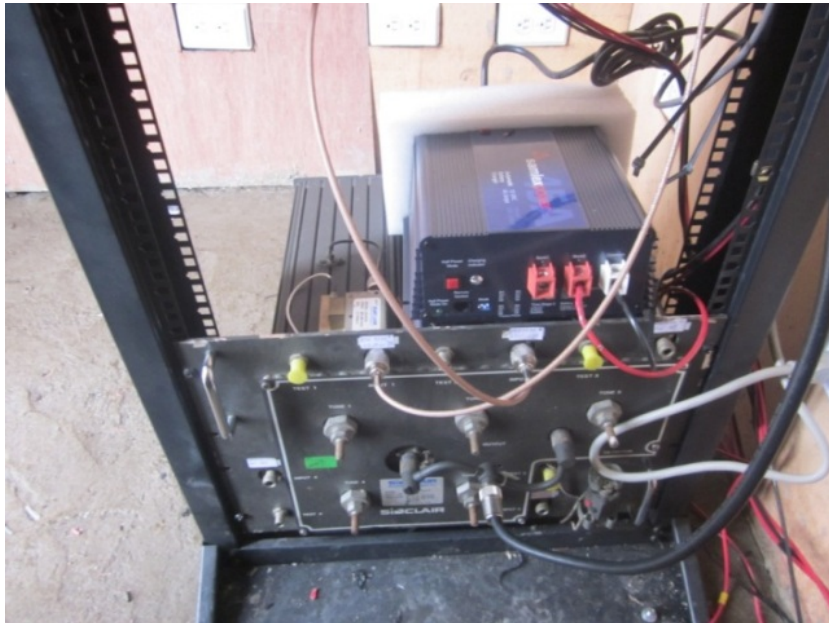
Figura 4.3: Combinador Sinclair instalado en rack [A]
