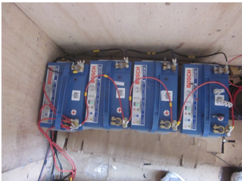
Figura 4.4: Banco de Baterías [A]
