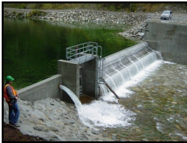
Foto 2.8: Obra de captación en pleno funcionamiento, captando agua 20 .
