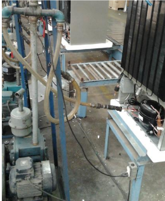
Figura 3.22. Estación de control de calidad (Bombas de vacío)
