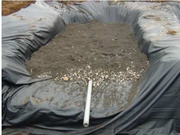
Figura 2.3 Fotografía del sistema de drenaje en cada uno de los cubetos (Musó, 2012).
