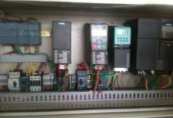
Figura. 15. Gabinete del Sistema de Control
