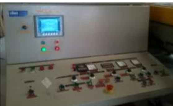
Figura. 16. Tablero de Control
