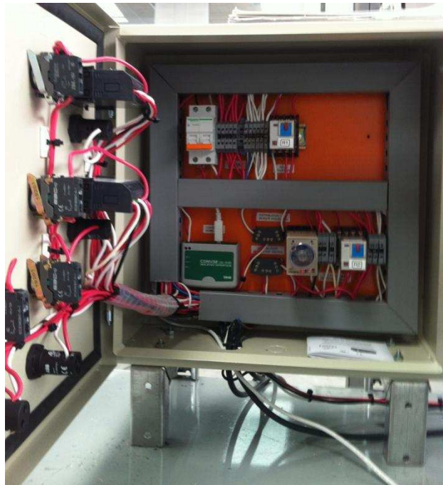
Figura 3. 35 Presentación final interior del tablero de control
