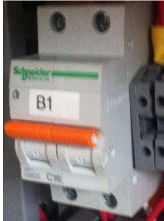
Figura 2. 35 Breaker de dos polos marca Schneider
