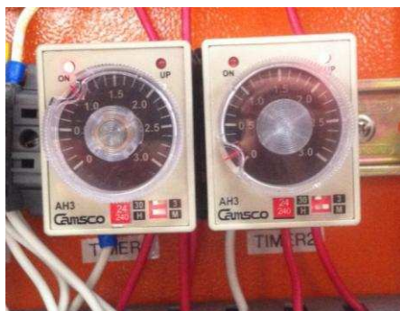
Figura 4. 51 Perillas de regulación para los temporizadores
