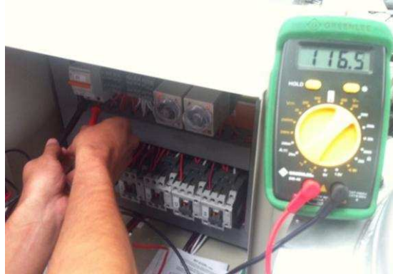
Figura 4. 21 Verificación del voltaje de alimentación al tablero.
