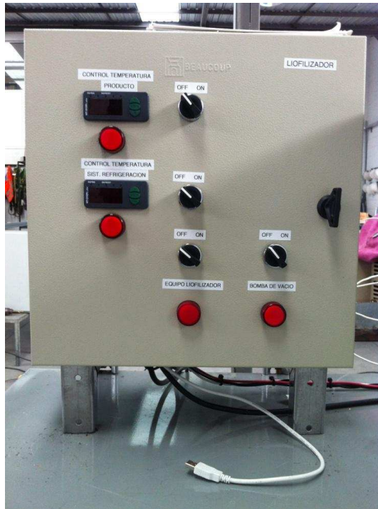
Figura 3. 36 Presentación final exterior del tablero de control
