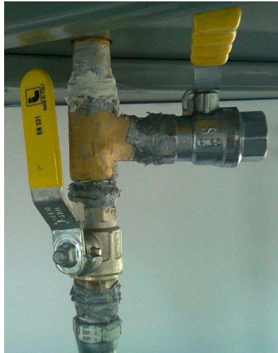
Figura 4. 31 Posicionamiento de las válvulas previo al inicio del proceso
