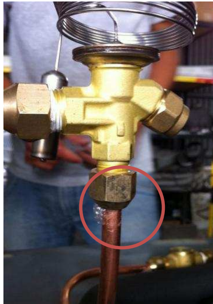
Figura 4. 10 Fugas en acoples de tubería de la válvula de expansión
