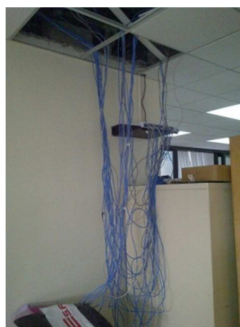
Figura 3.47 Cableado del DCC
