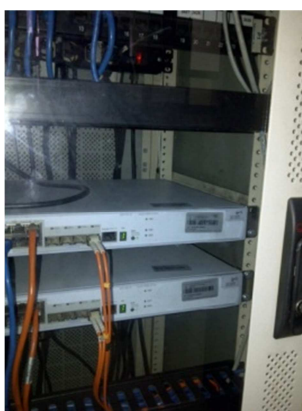
Figura 3.9 Switch principal – Acercamiento
