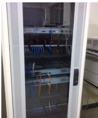
Figura 3.8 Switch principal - Oficina de Servidores
