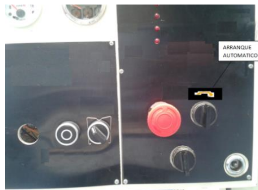
Figura U. 11 Selector en estado Automático en el Panel de Operación del G.E.
