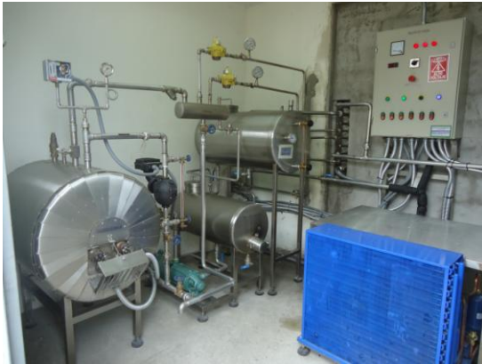
Figura 8. Caldero y Tablero fuerza
