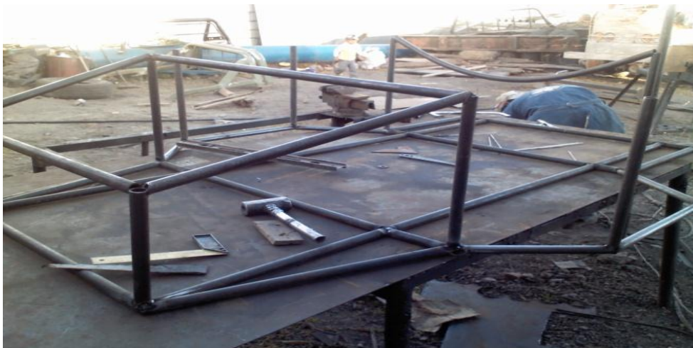
Figura 4.9.- Parte frontal de bastidor
