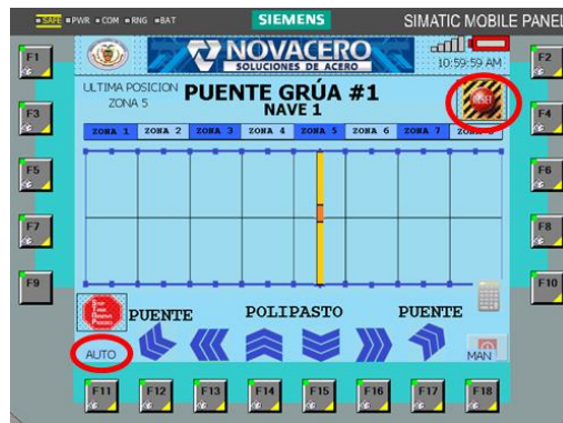
Figura 8: Pantalla de operación del puente grúa
