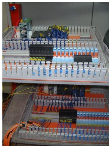
Figura 2.134: Conexiones de los tableros de control PUENTE GRÚA 1 y 2
