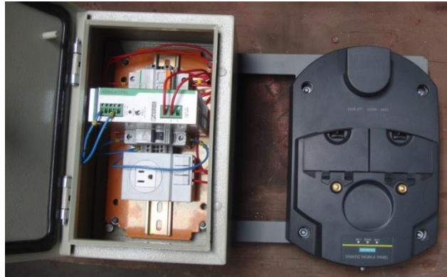
Figura 2.135: Gabinete de carga de los controladores.
