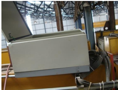
Figura 2.141: Montaje del tablero de control
