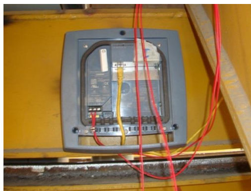
Figura 2.144: Instalación de los equipos y conexiones listo para las pruebas de operación
