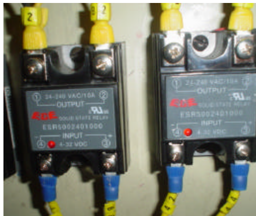
Figura. 3.22. Relé de estado sólido instalados
