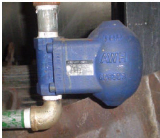
Figura. 3.35. Trampa de vapor
