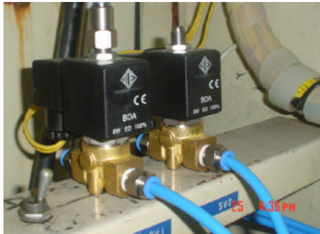
Figura. 3.23. Electro válvulas instaladas
