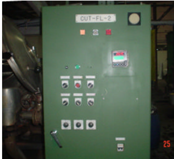
Figura. 3.32. Vista frontal del panel de control
