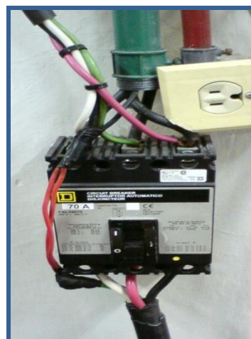
Figura 3.3 Switch de encendido principal.
