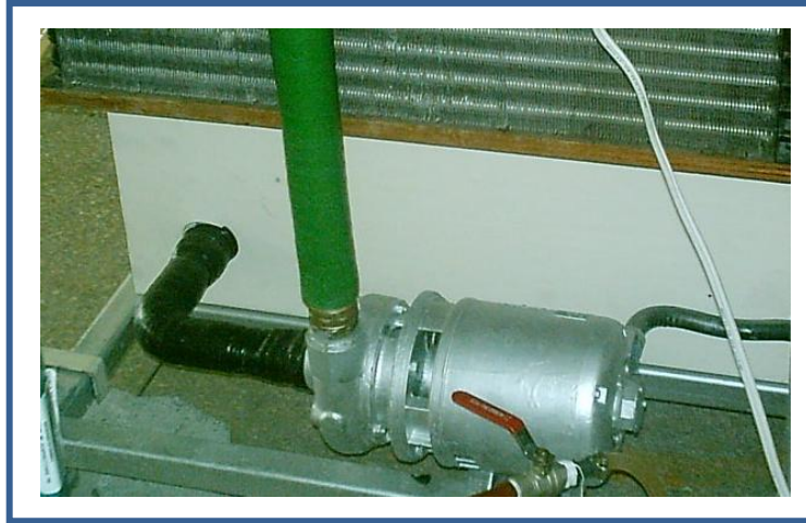
Figura 3.10 Bomba Centrífuga del Lado Frío.
