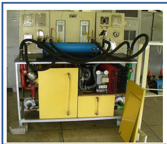
Figura 3.12 Posición del intercambiador en el banco de pruebas.
