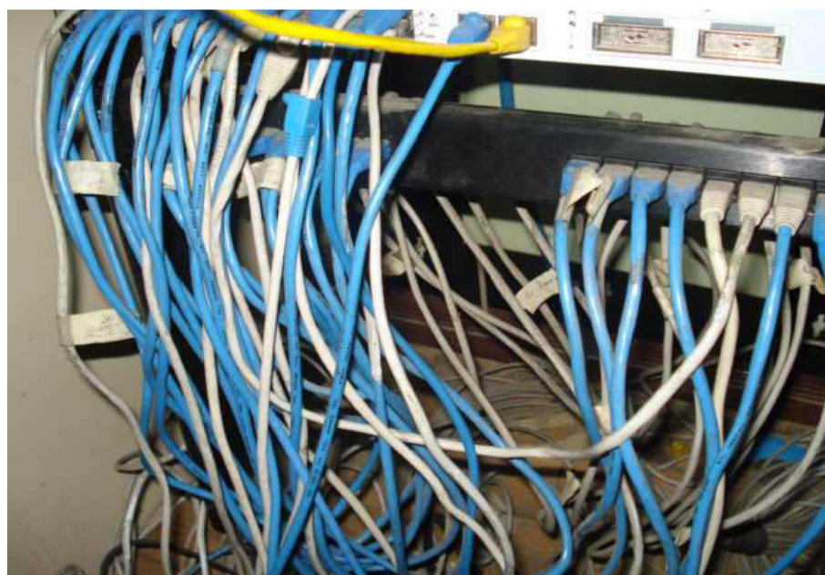
Figura 3.17: (Departamento administrativo equipos activos y pasivos).
