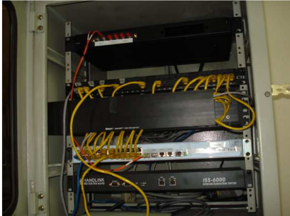
Figura 3.16: (Cuarto de telecomunicaciones equipos activos y pasivos).
