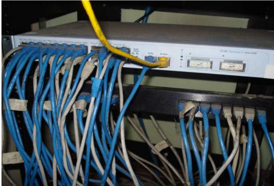
Figura 3.18: (Departamento administrativo equipos activos y pasivos).
