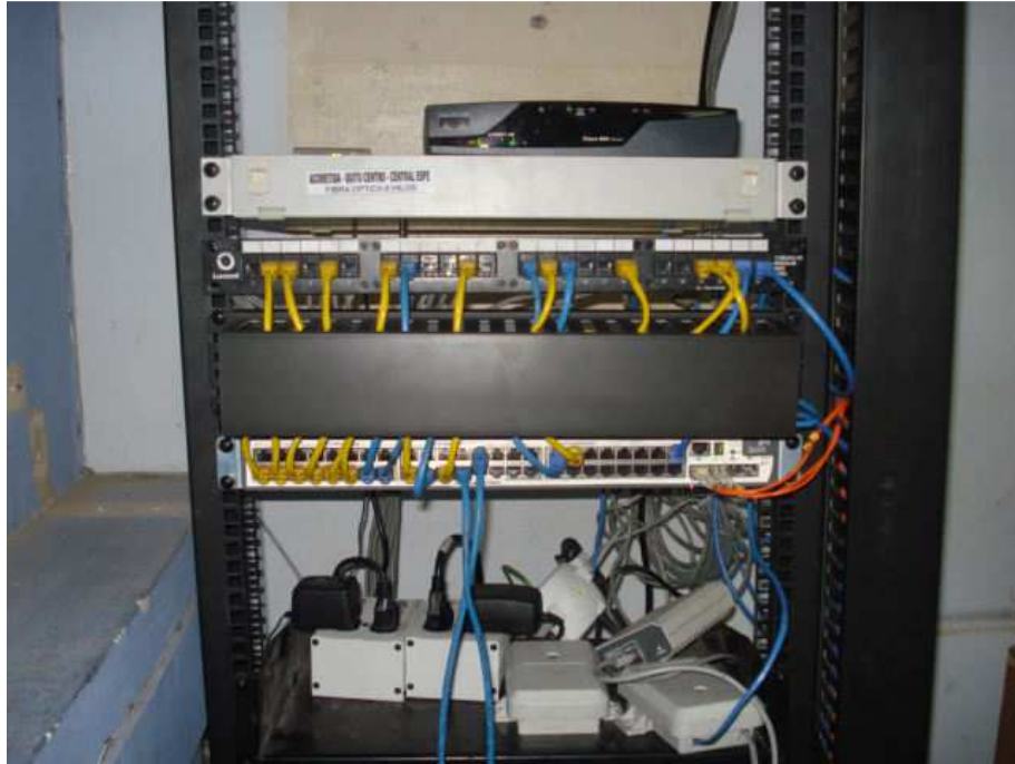
Figura 3.22: (Oficina laboratorios equipos activos y pasivos).
