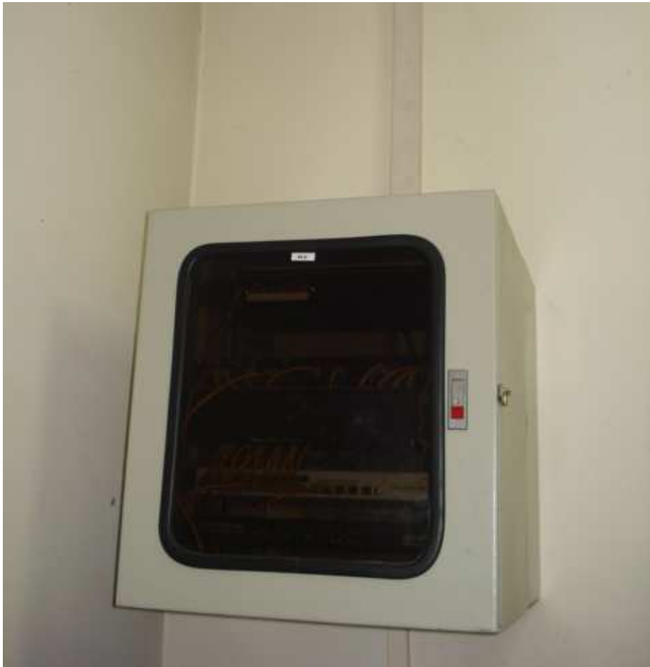
Figura 3.15: (Cuarto de telecomunicaciones equipos activos y pasivos).
