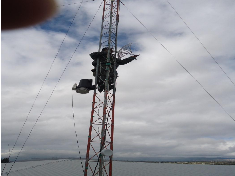
Conexión de la antena a la estación
