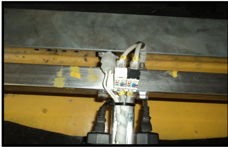
Figura 15: Dos jacks de datos y bornera.
