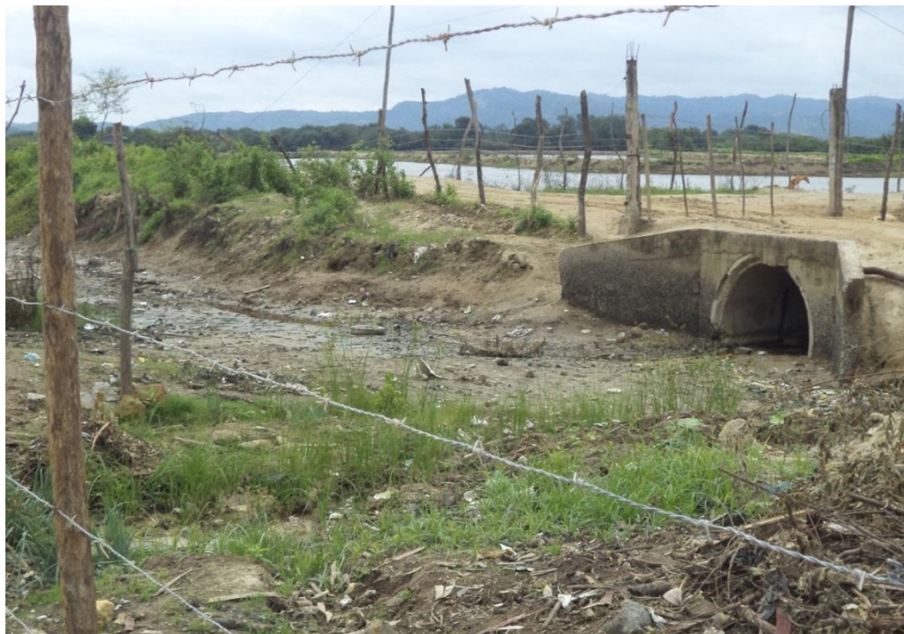
Foto 4.20: Vulnerabilidad de red vital-alcantarillado, ante una inundación pluvial, Barrio Santa Isabel, se puede observar la colmatación de pozos.
