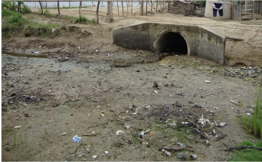
Foto5.13:. Barrio Santa Isabel, colapsamiento de red de alcantarillado por falta de infraestructura, esto es una problemática para la comunidad ya que es un foco de infecciones para la salud de los pobladores.
