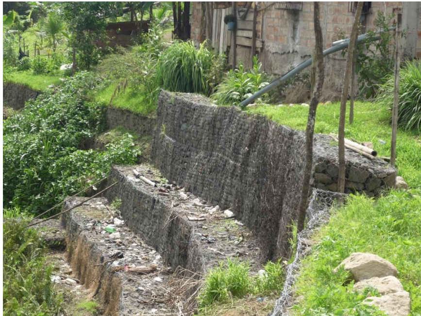
Foto 5.21: Barrio El Progreso, descarga directa al canal del Bálamo y falta de mantenimiento del mismo.
