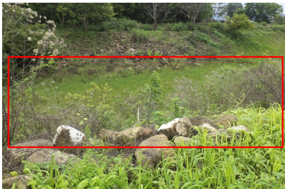
Foto 5.20: Barrio Rancho Rojo, falta de mantenimiento del Canal del Bálsamo se encuentra cubierto de maleza agua estancada y basura.
