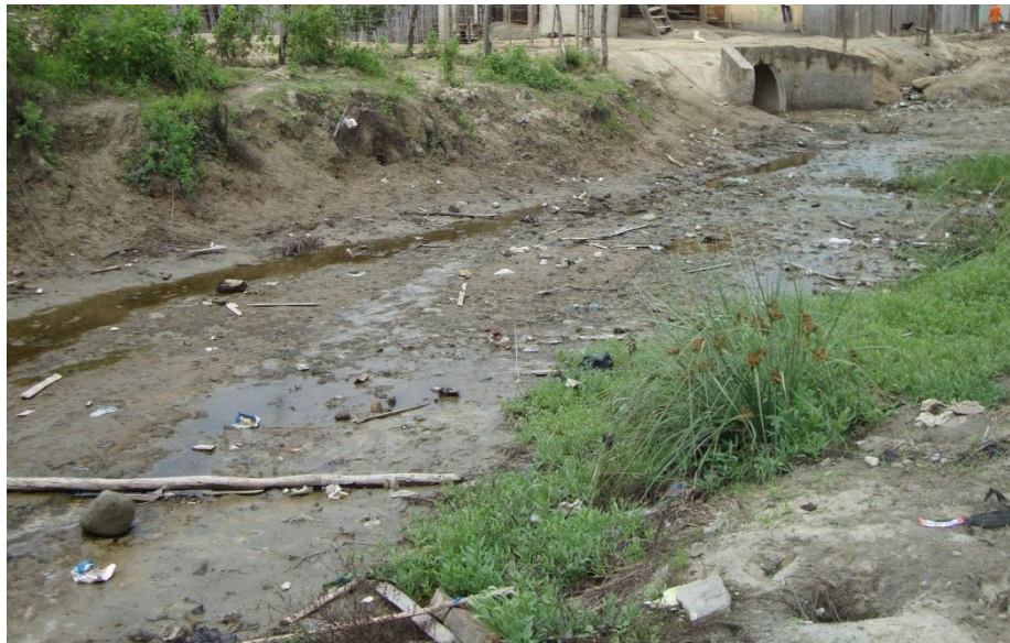
Foto 5.8: Barrio Santa Isabel colmatación de red de alcantarillado, problemas ambientales y de salud.
