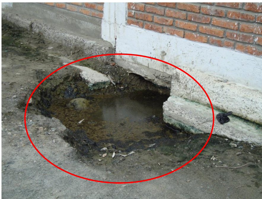
Foto 4.25: Vulnerabilidad ambiental, Barrio La Esperanza, se observa como las calles se encuentran con agua estancada.
