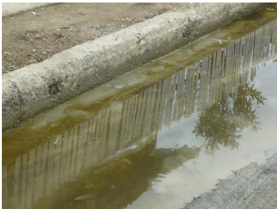
Foto 5.9: Barrio Santa Martha 1 Falta de alcantarillado
