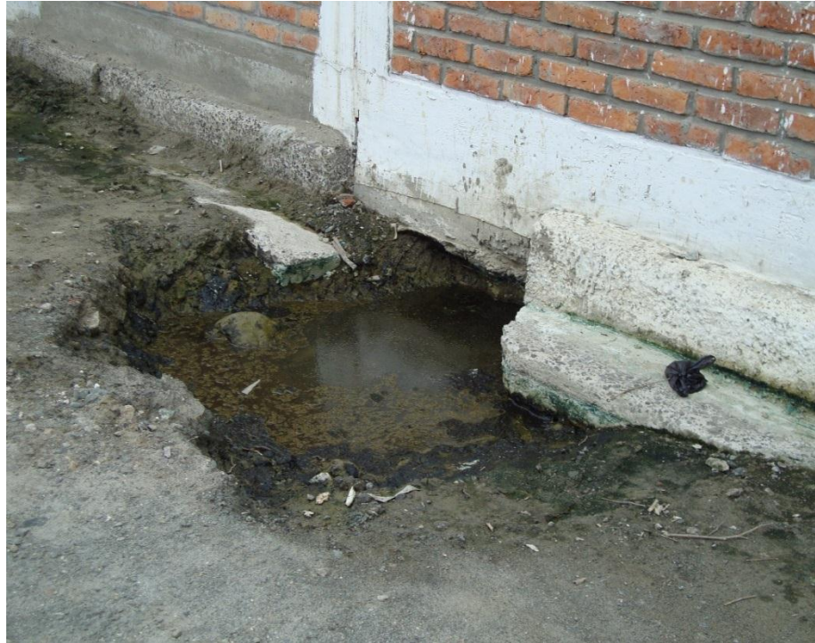
Foto 5.7: Barrio La Esperanza falta de alcantarillado, problemas ambientales y de salud.
