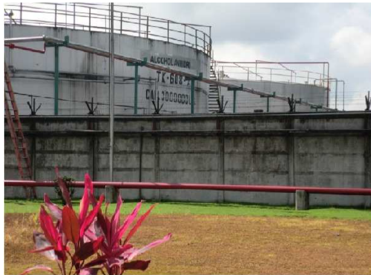
Figura 2.15. Tanques de almacenamiento de alcohol anhidro
