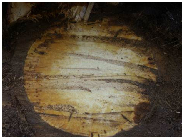
Figura 1.2 Corte transversal del pseudotronco de una planta afectada por ML.
