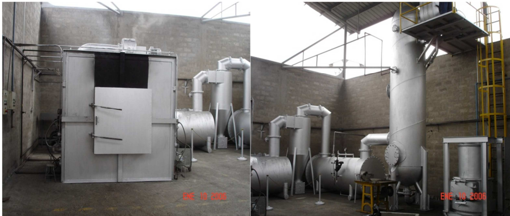
Figura 1.5 Equipo de gasificación termoquímica con lavador de gases
